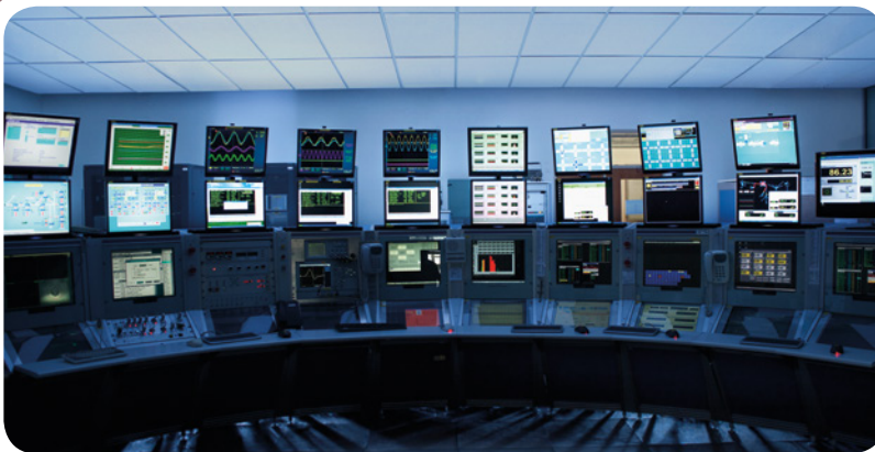
Blick in eine Leitwarte – bei einer Störungsmeldung können mit Unterstützung durch BGI Analytics alle weiteren Aktionen im direkten räumlichen Zusammenhang abgewickelt werden.
